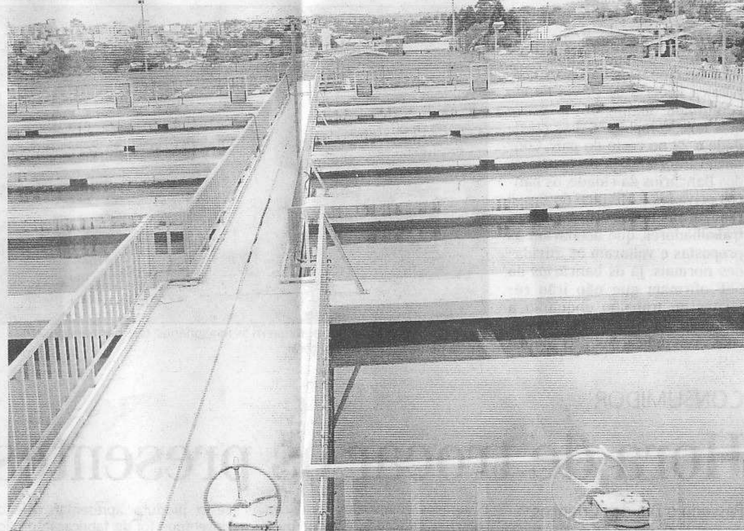
Estação de Tratamento de Água do bairro São Luiz Gonzaga trata 22 mil litros cúbicos de água por dia
